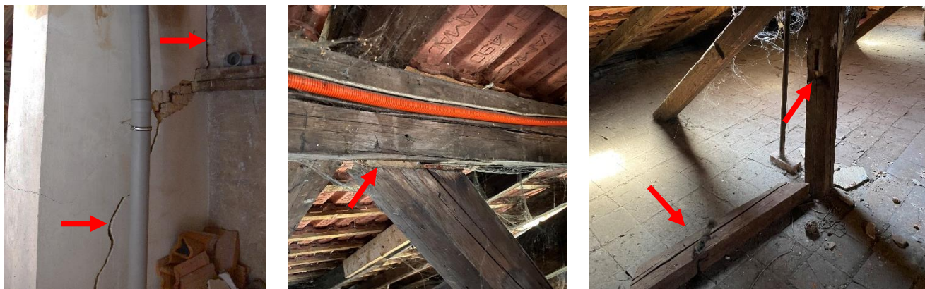
Slika 5. – Oštećenja dimnjaka i/ili odvajanja zabata (lijevo), izvlačenje kosnika iz podrožnice (sredina) i ispadanje kosnika (desno)
