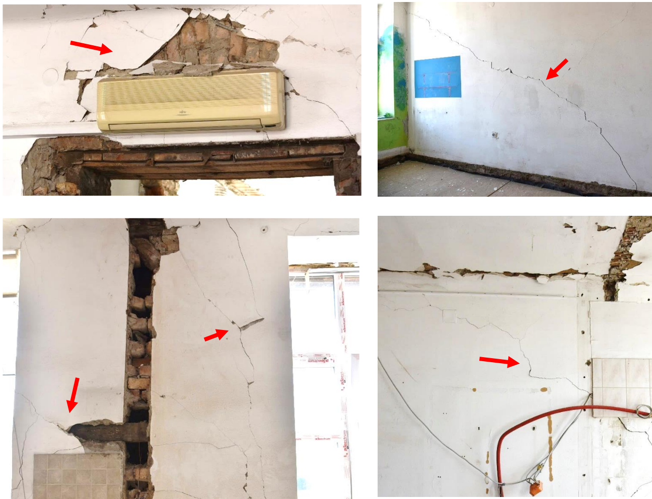
Slika 9. – Oštećenje nadvoja unutarnjega nosivog zida (gore lijevo), dijagonalna pukotina unutarnjeg zida (gore desno), oštećenje fasadnog zida (dolje lijevo) i oštećenje stubišnog zida (dolje desno)
