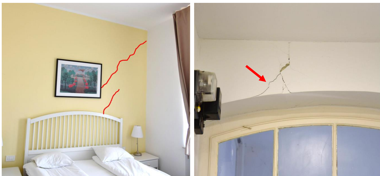
Slika 18. – Prikaz oštećenja južnog zabatnog zida (lijevo) i nadvoja kod ulaza u sjeverni poslovni prostor (desno)
